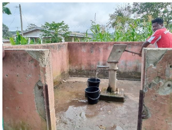
Image 36: PMH fonctionnelle à pont So'o
