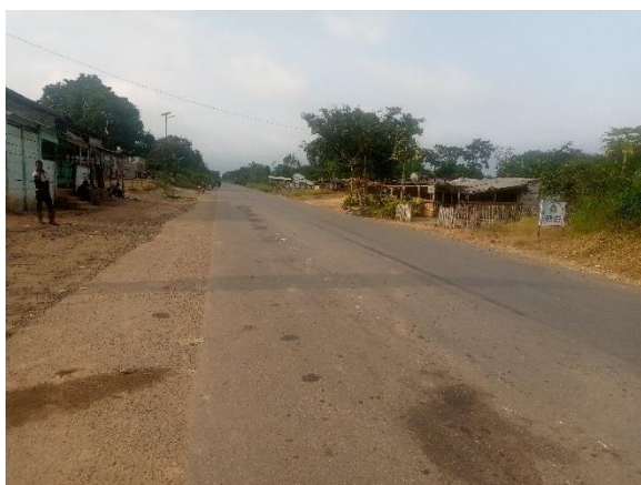
Image 39: État de la RN2, au niveau de pont So'o
